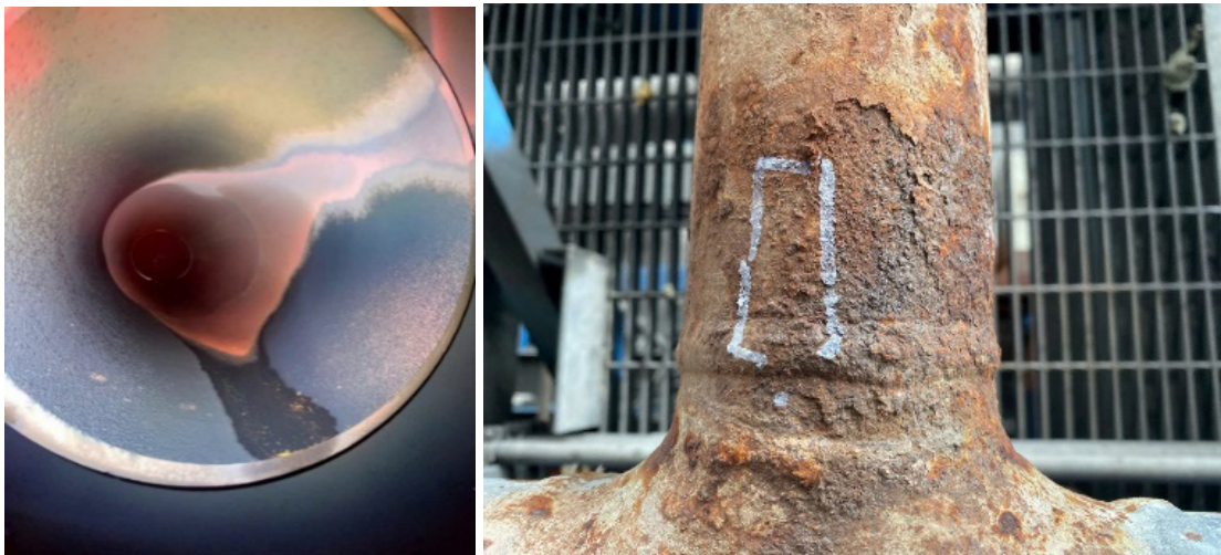
Hình 2. Ăn mòn FAC (bên trái) và CUI (bên phải) trong nhà máy nhiệt điện.
