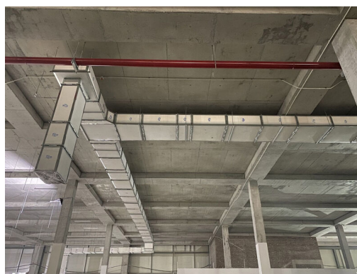
Hình 2. Hệ thống thông gió hút khói được bọc bảo vệ bởi tấm chống cháy geopolimer.
